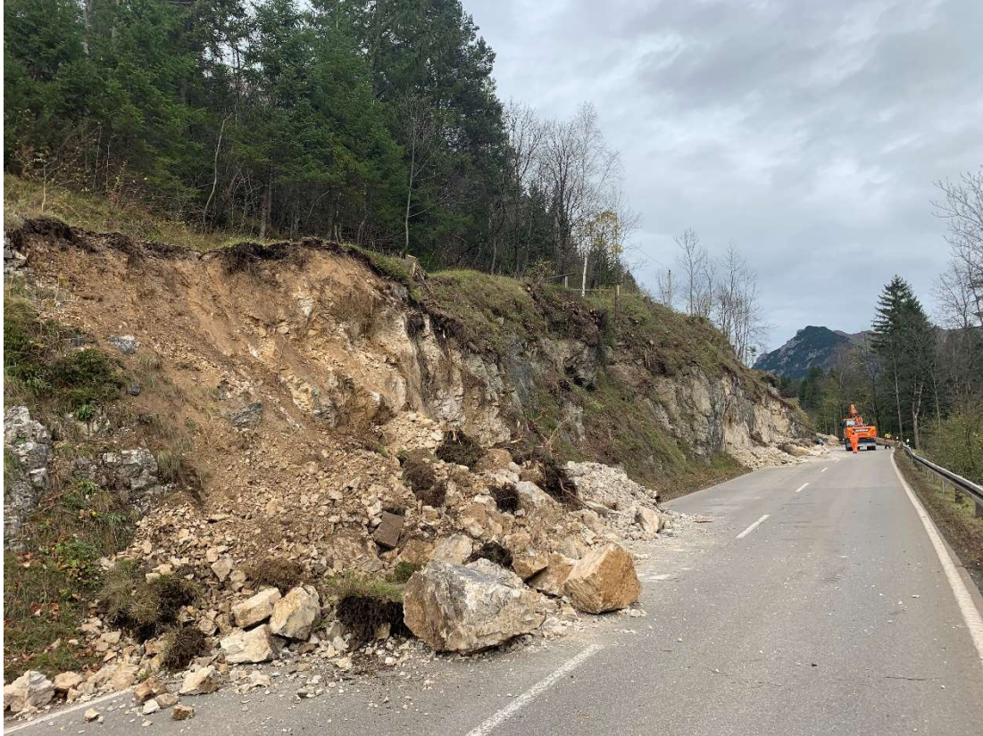
Abgerutschte Felsböschung an der St 2542 (Foto: Staatliches Bauamt Weilheim)
